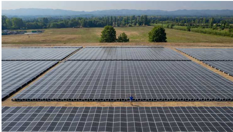
Centrale solaire photovoltaïque de Saint-Rémy-de-Provence au chemin des Méjades (sur le site de l'ancienne décharge municipale)
