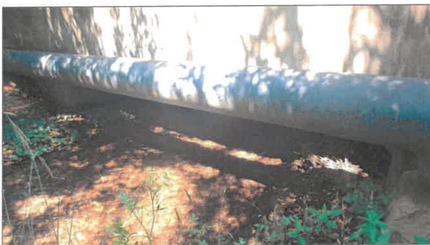
Figure 13 : réduction de la section du gaudre au droit du passage sous la route de la Massane
