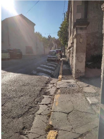
Point n°19 - Trottoir dégradé avenue Durand Maillane
