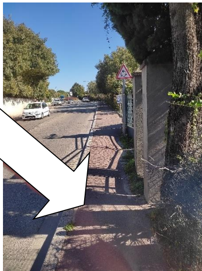
Point n°4 - Tassement de sol et trottoir en pente sur la D99
